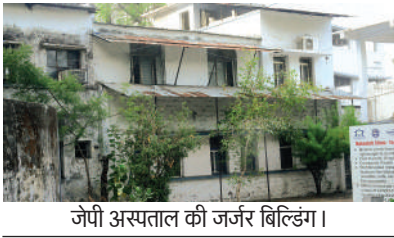
जेपी अस्पताल की जर्जर बिल्डिंग।
